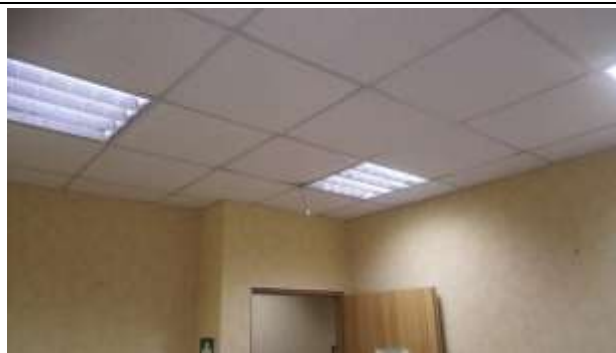
Фото 7.12. Состояние отделки потолка и стен.
