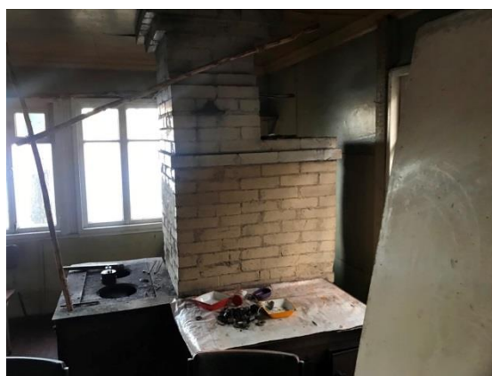
ФОТО № 28. Вид внутри здания столовой щитовой
