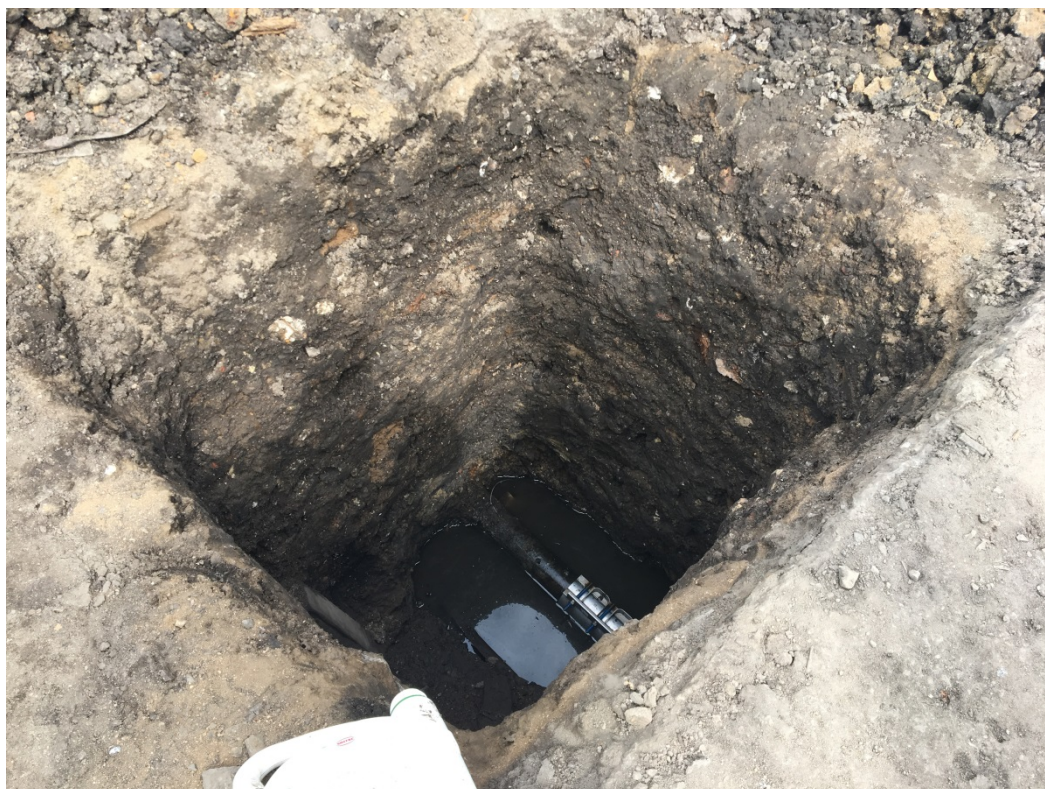
Сооружение (сеть водопроводная в комплекте трубы чугунные)
