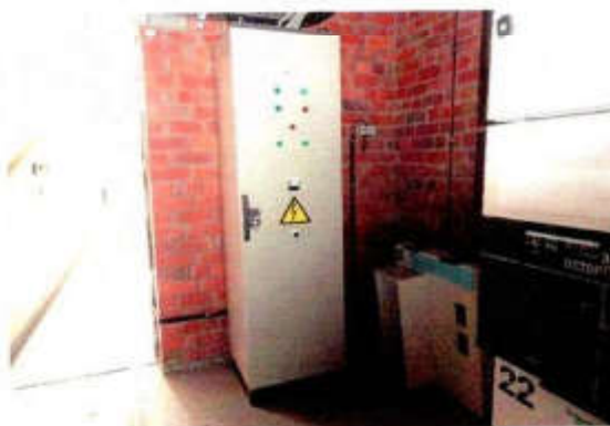
Фотография 6. Шкаф оперативного постоянного тока ШОТ-ТЭВ-05
