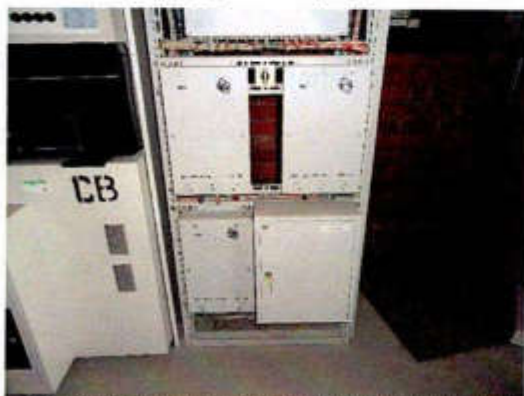
Фотография 11. Аппаратура контролируемого пункта Уктус- ТМ
