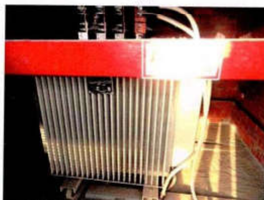
Фотография 14. Трансформатор ТМГ 400/10-11
