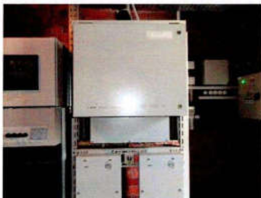
Фотография 10. Аппаратура контролируемого пункта Уктус-
