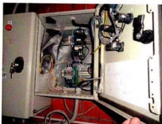
Фотография 16. Ящик управления электроотоплением ЯЭ1401 УХЛ2
