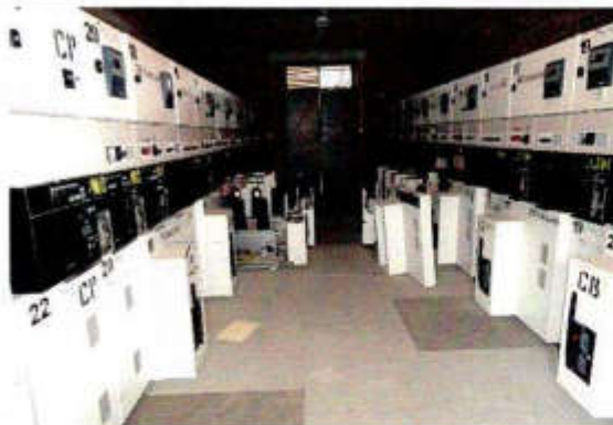
Фотография 1. Распределительные ячейки 10 кВ SM6
