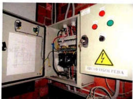
Фотография 15. Щиток АВР ЯА, Шкаф обогрева
