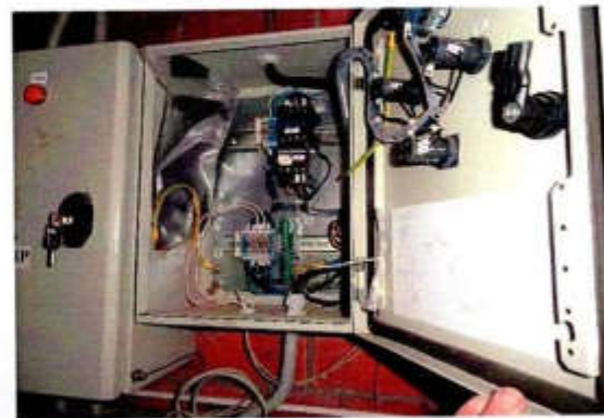
Фотография 8. Ящик управления электроотоплением ЯЭ1401 УХЛ2
