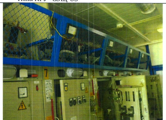
ФОТО № 12. Вид оборудования КРУ 6 кВ типа КСО-298М
