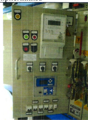
ФОТО № 6. Вид оборудования КРУ 6 кВ типа КСО-298М
