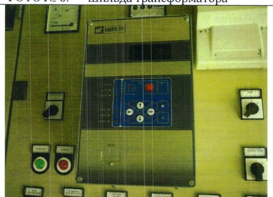
ФОТО № 10. Вид оборудования КРУ 35 кВ типа КРУ=СЭЩ-65
