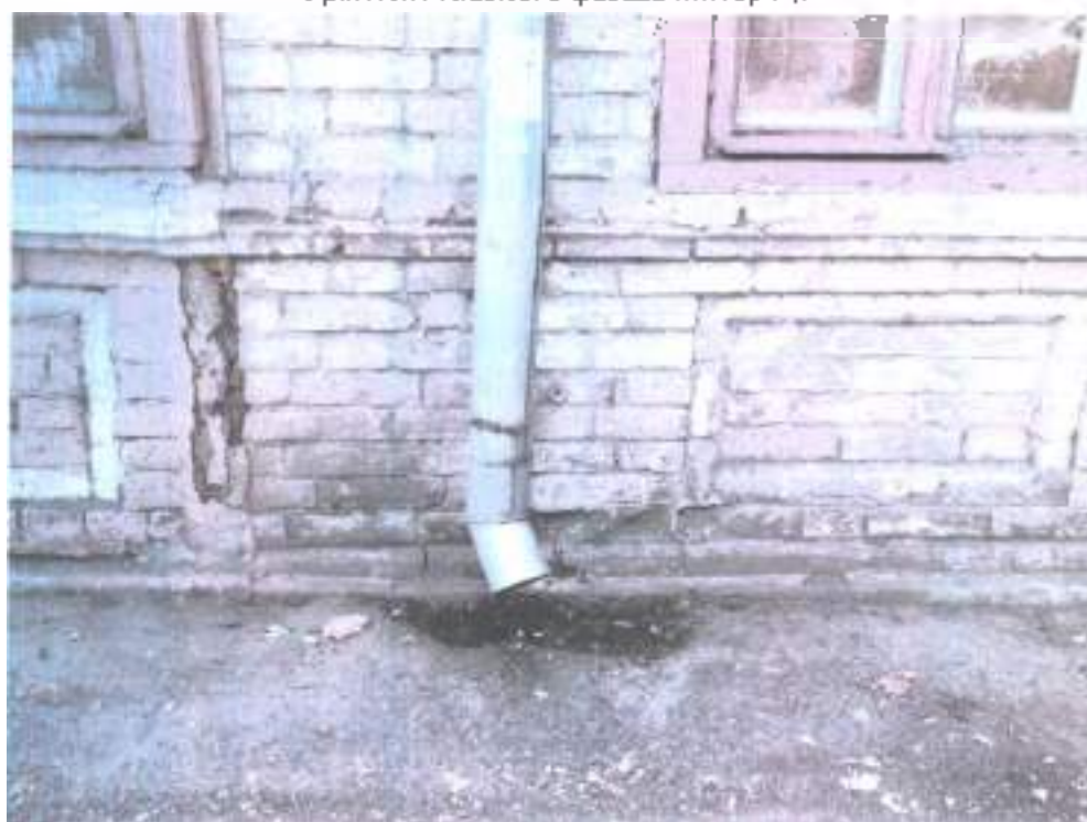
Фото 21. Объект культурного наследия федерального значения «Подворье Карповых, где Лермонтов Михаил Юрьевич провел последнюю ночь перед дуэлью», 1841 г., Ставропольский край, г. Железноводск, ул. Семашко, 9/11. Состояние цоколя, отмостки (литер Г).
