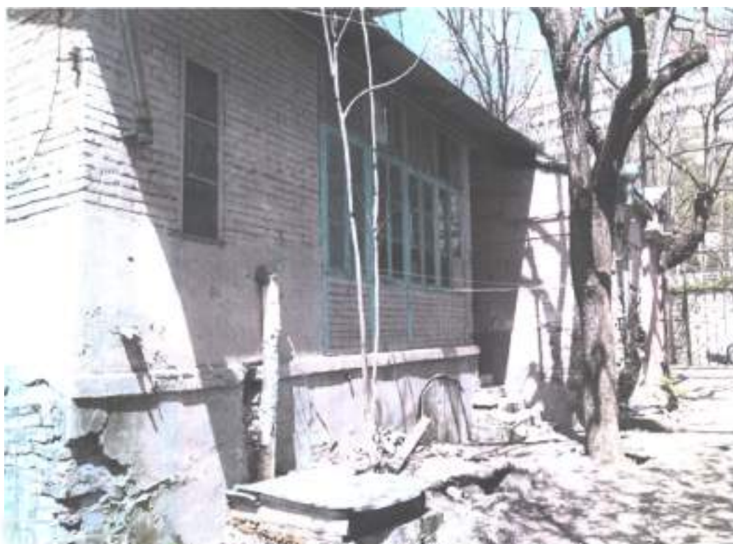
Фото 14. Объект культурного наследия федерального значения «Подворье Карновых, где Лермонтов Михаил Юрьевич провел последнюю ночь перед дуэлью», 1841 г., Ставропольский край, г. Железноводск, ул. Семашко, 9/11. Деревянный фасад (литер В).
