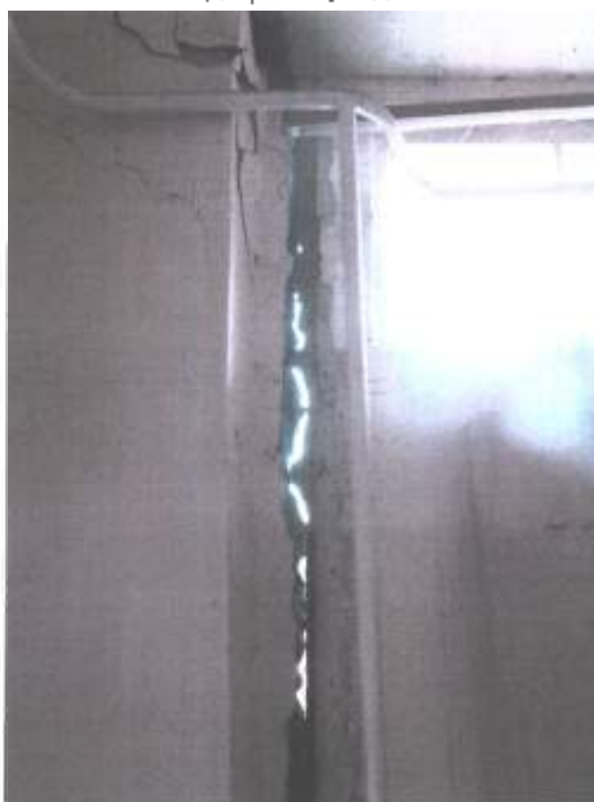
Фото 27. Объект культурного наследия федерального значения «Подворье Карповых, где Лермонтов Михаил Юрьевич провел последнюю ночь перед дуэлью», 1841 г., Ставропольский край, г. Железноводск, ул. Семашко, 9/11. Сквозная трещина в северо-восточном углу (литер 1').
