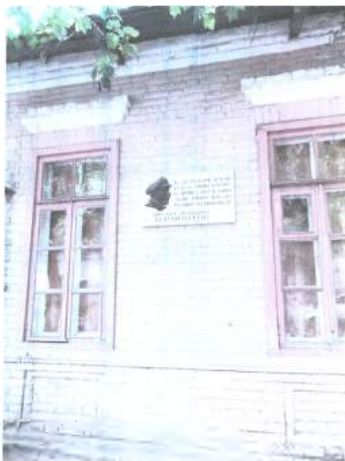
Фото 20. Объект культурного наследия федерального значения «Подворье Карповых, где Лермонтов Михаил Юрьевич провел последнюю ночь перед дуэлью», 1841 г., Ставропольский край, г. Железноводск, ул. Семашко, 9/11. Фрагмент главного фасада (литер Г).
