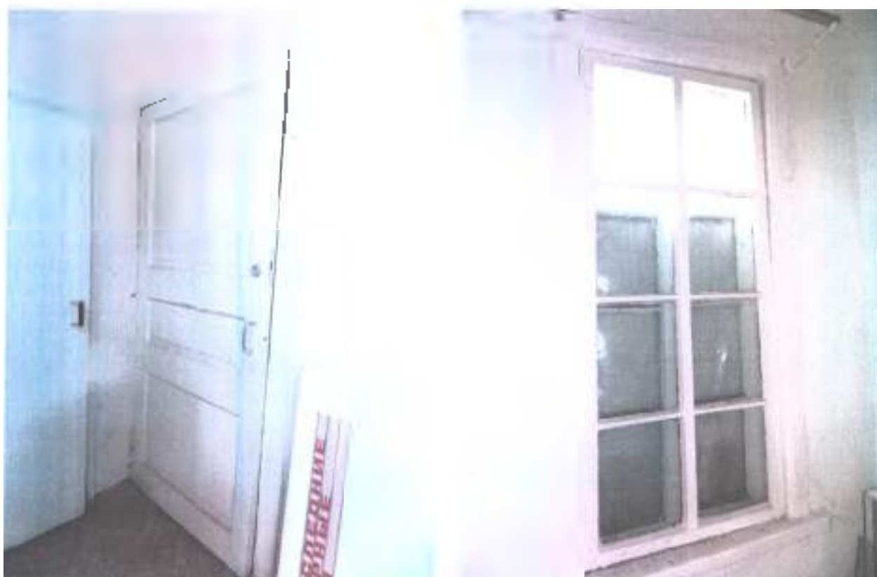
Фото 30-31. Объект культурного наследия федерального значения «Подворье Карповых, где Лермонтов Михаил Юрьевич провел последнюю ночь перед дуэлью», 1841 г., Ставропольский край, г. Железноводск, ул. Семашко, 9/11. Состояние оконных и дверных заполнения (литер Г).
